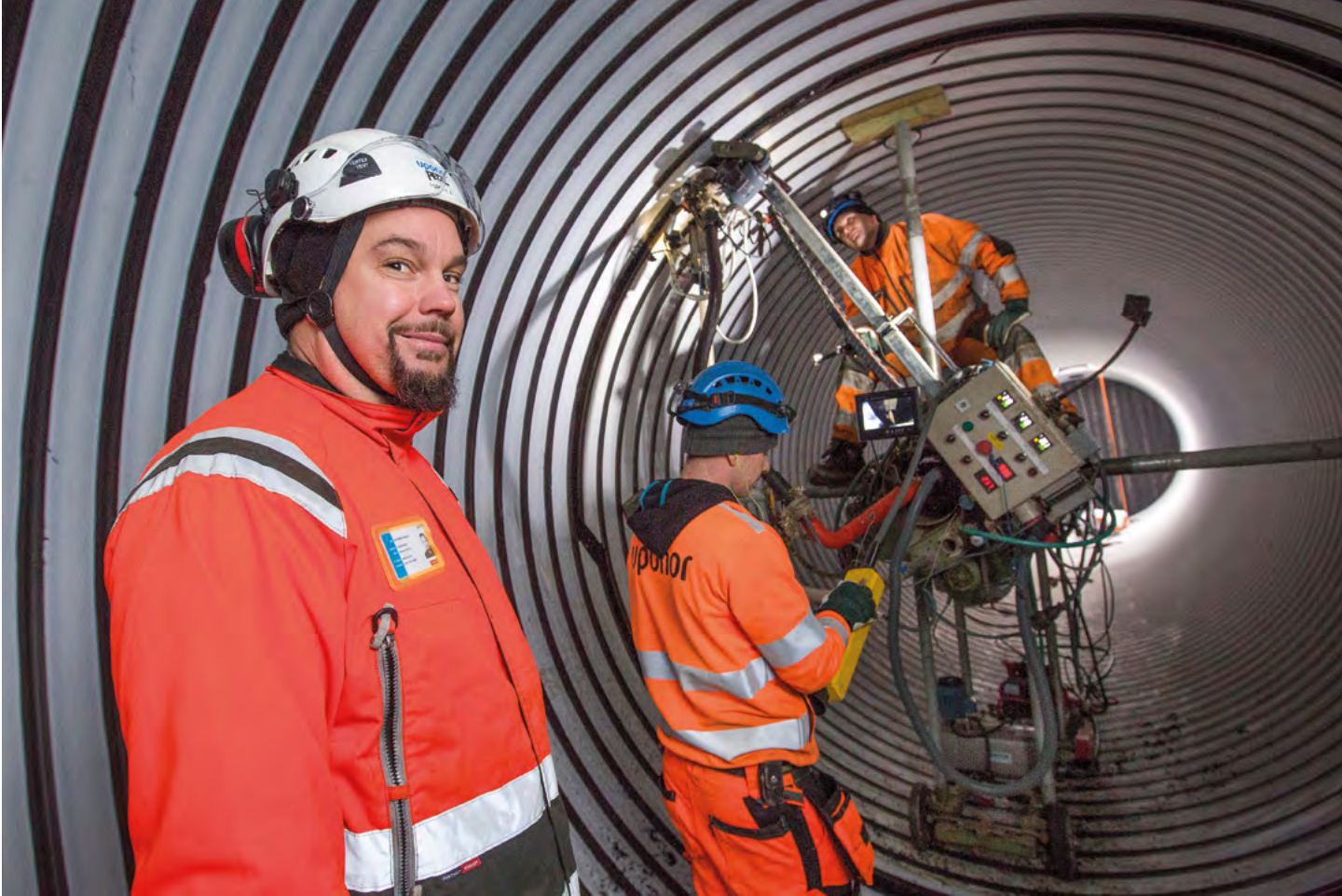
30 metrin pituiset Weholite®-säiliöt asennettiin Riihimäen jätevesilaitokseen vuoden 2016 lopulla. Säiliöiden sisähalkaisija on 3 metriä ja tilavuus yli 200 m 3 , ja ne takaavat laitoksen toiminnan myös hätätilanteissa.
