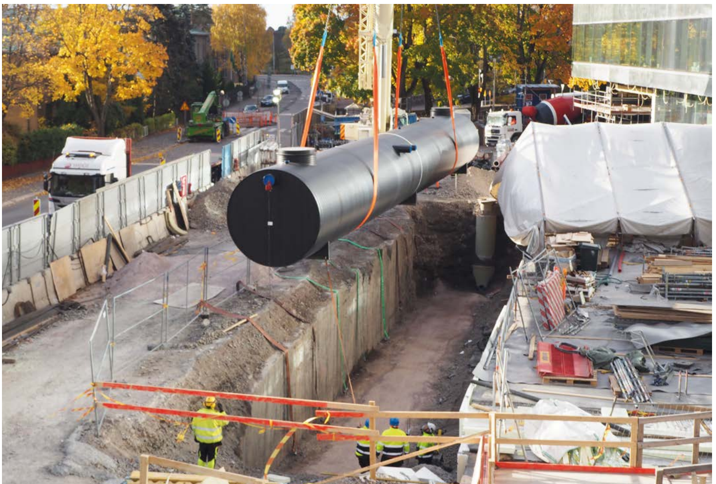
Uponor on lahjoittanut Helsingin uuden lastensairaalan rakentamiseen käyttövesijärjestelmiä ja muita ratkaisuja. Sairaalaan asennettiin lokakuussa 2016 Uponorin Weholite® hulevesisäiliö.
