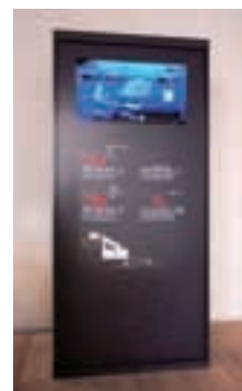
東京リサーチパークの太陽光発電情報パネル
