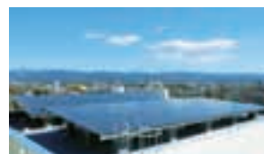
富士工場の太陽光発電設備
