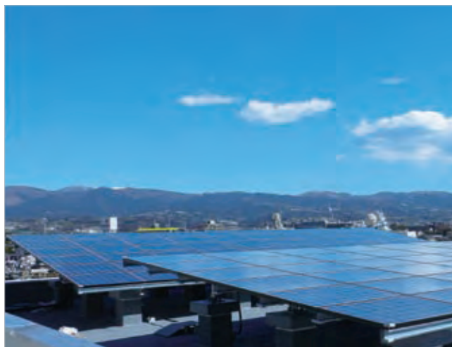
富士工場の太陽光発電設備
