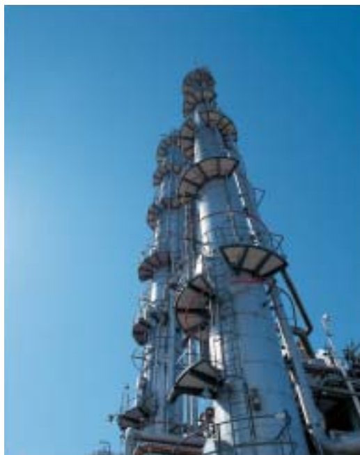
蒸留塔(協和油化・四日市工場)
