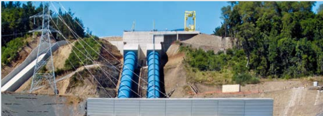
ERZEUGT JÄHRLICH BIS ZU 464 GWH ELEKTRISCHE ENERGIE
